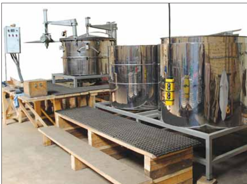
Рис. 3. Общий вид пропиточного комплекса КПА-1000 в ООО «АкваПроп» (Санкт-Петербург)
